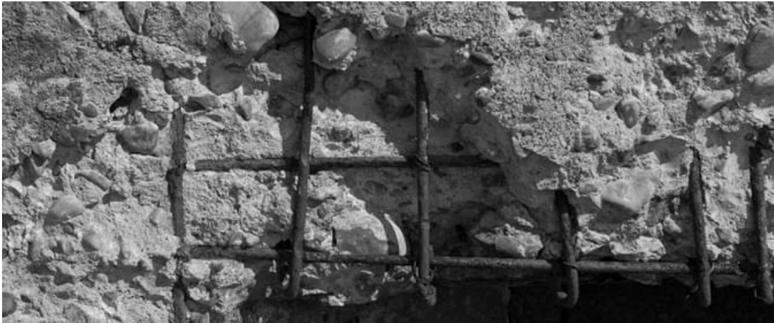
Figura 2 Peça estrutural em concreto armado, com oxidação da armadura em aço e desagregação de recobrimento. Fonte: Paula, Carla Castro de. Patologias de estruturas de concreto: identificação e tratamento . AEC Web. São Paulo, 2018. Disponível em: < https://www.aecweb.com.br/cont/m/rev/patologias-de-estruturas-de-concreto-identificacao-e-tratamento_14342_10_0 >. Acesso em: 27 jan. 2019.
