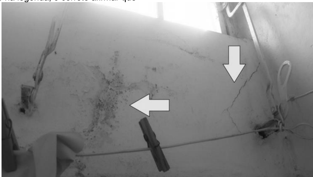
Figura 1 Infiltração, mofo e trinca na parede. Fonte: Presotto, Maria Izabel Milani; Eberle, Camila R.; de Toni, Regina; Trevisan, Francisco. Perícias de Engenharia na construção civil – estudo de caso. Revista técnico-científica do CREA-PR, Curitiba-PR, set. 2017, p. 60.
